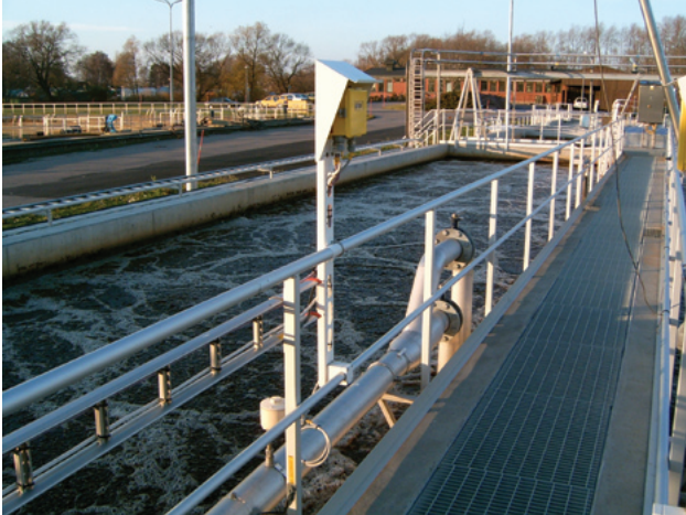
Station d'épuration des eaux usées typique
